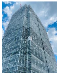
マンション新築工事 外部足場・タワークレーン 工事用エレベータ設置
